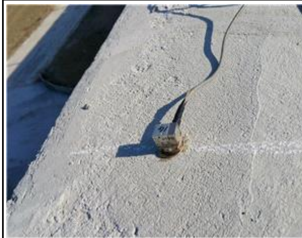
가속도계 설치 현황
