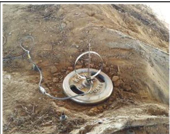
처짐계 설치 현황
