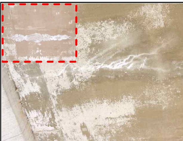
바닥판 하면 균열부 백태(보수완료)
