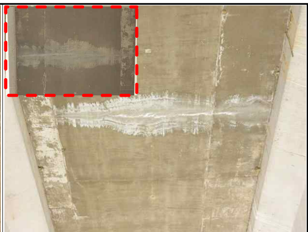
바닥판 하면 균열부 백태(보수완료)
